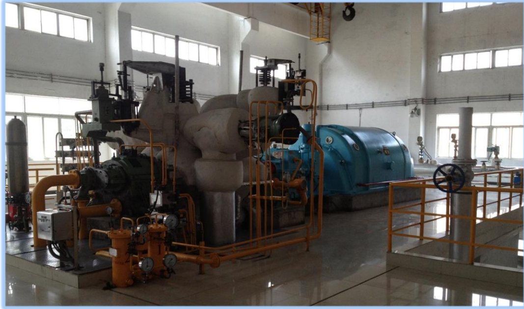
图 1 15MW 发电机组
