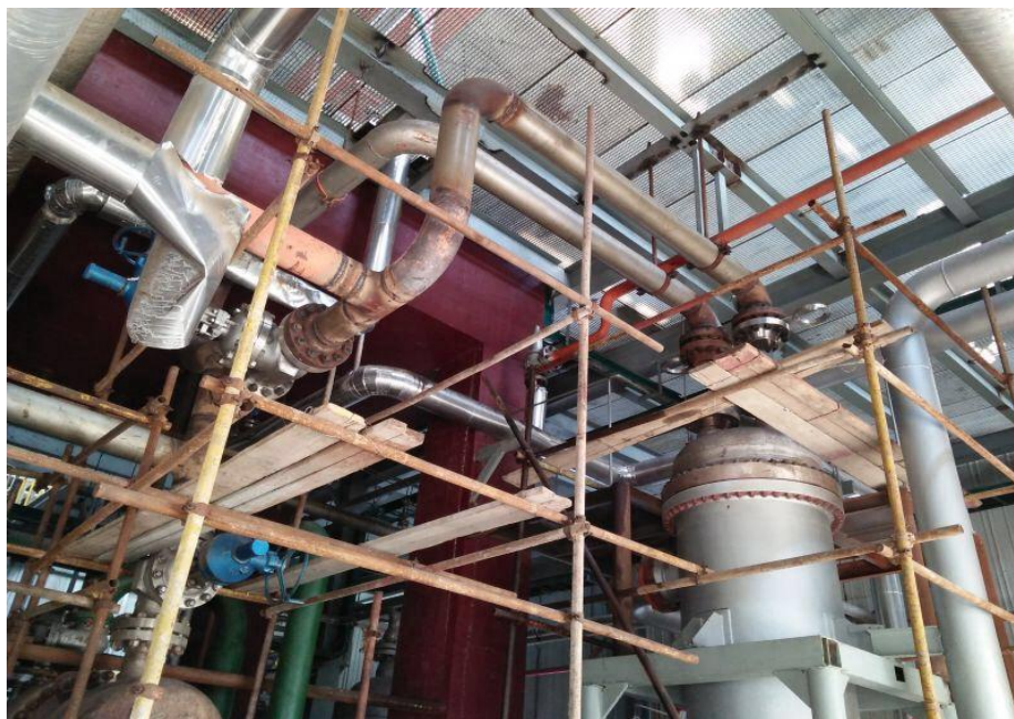
图 13 大修整改后二段出口管道
